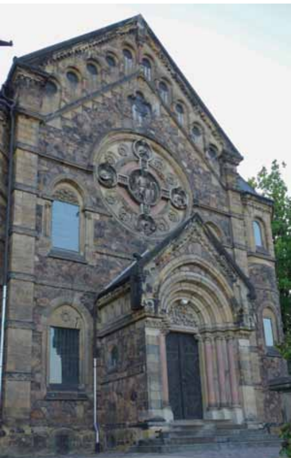
▲ Abb. 3: Fassade der Lutherkirche in Freital-Döhlen (1881/82). Bruchsteinmauerwerk aus Andesit mit Gliederungs- und Schmuckelementen aus Elbsandstein und Rochlitzer Porphyrtuff. Foto: Heiner Siedel.
